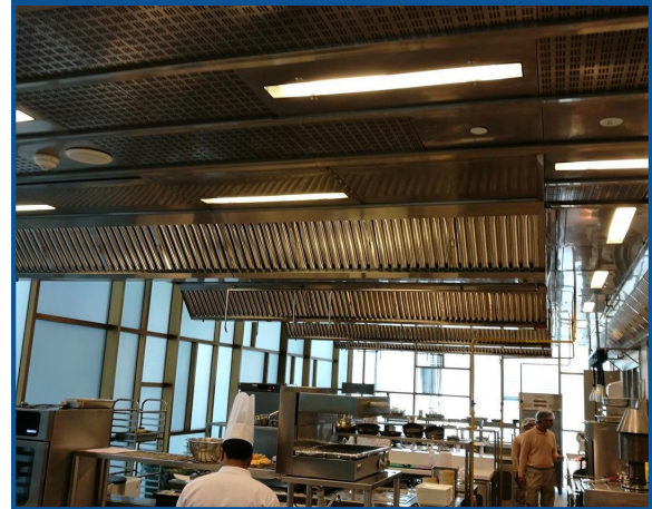
Techo filtrante de 60m 2 instalado en un resort en los Emiratos Árabes en la ciudad de Ajmán.
