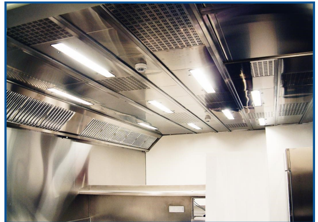
Techo filtrante de 30 m 2 instalado en la cocina del casino de Barcelona.
