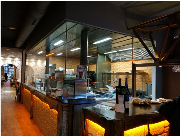
Techo filtrante de 40m 2 instalado en cocina a vista con vidrio protector en Bilbao.
