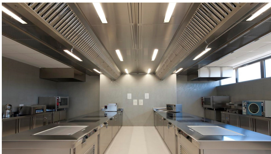
Techo filtrante de 50m 2 instalado en Benidorm (Alicante).
