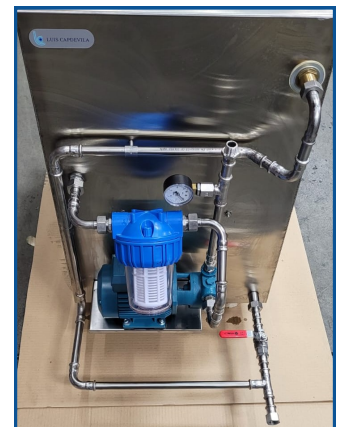
Conexiones de agua, filtro y bomba
